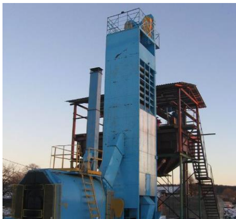
Рис. 90. Загальний вигляд зерносушарки на твердому паливі.
