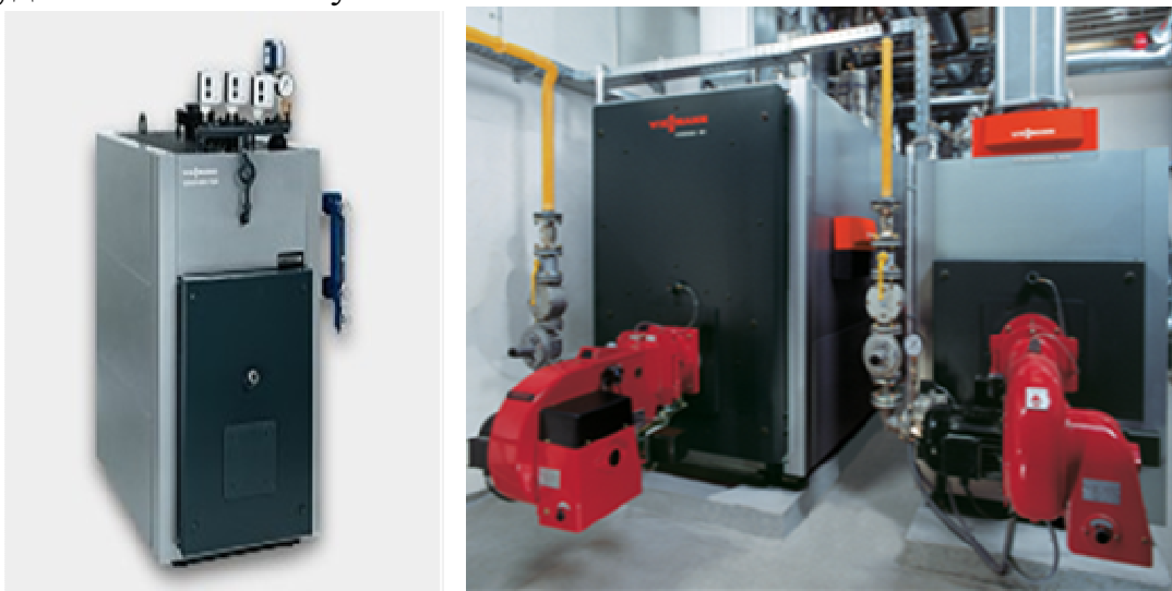
Рисунок 3.22 – Обладнання котельної з котлами фірми Viessmann - Vitoplex 100
