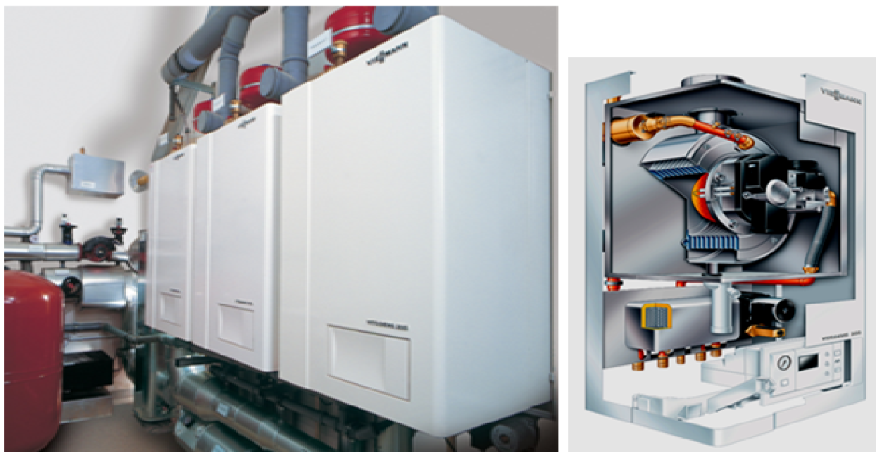
Рисунок 3.6 – Обладнання топкової з котлами фірми Viessmann-Vitodens 200
