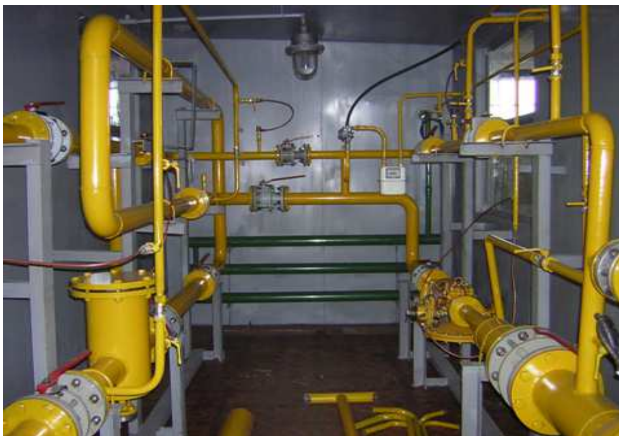
Рисунок Б.5 – Сучасне обладнання ГРПБ після реконструкції
