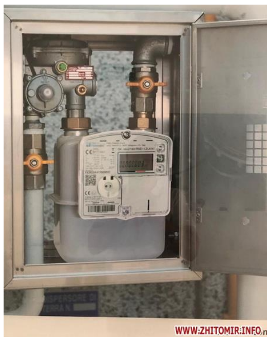
Рис.3.2 – Приклад встановлення пункту шафового побутового FE-6 по за межами будинку (всередині шафи, ліворуч - двоступеневий регулятор тиску газу, в центрі лічильник газу, запірна арматура)
